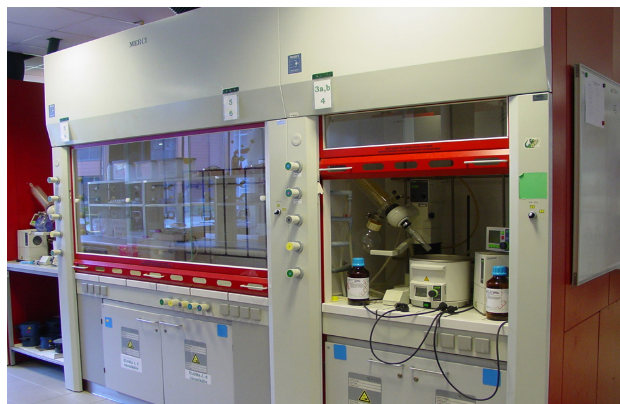
Digestoře v nové posluchačské laboratoři v pavilonu A10.
